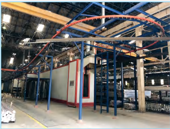
Dây chuyền sơn tĩnh điện Powder coating line
